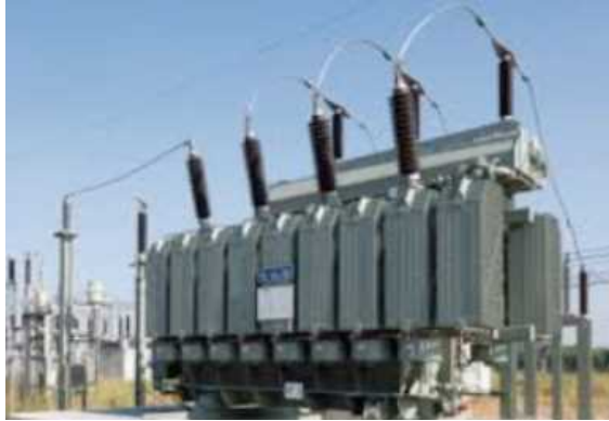
Gambar 41. Trafo step up Sumber : limakilo.id
