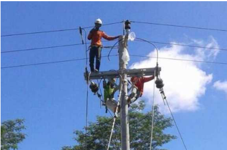
Gambar 44. Distribusi Listrik Sumber : Detik.com
